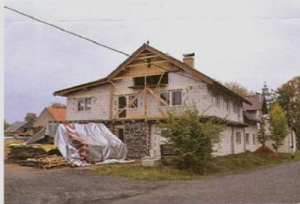
V nově vznikajícím bytovém zařízení pro klienty postižené Alzheimerovou chorobou bude 40 lůžek. Solární panely Zelené energie, která budou pro pacienty ohřívat vodu, jsou již nainstalovány na střeše.
